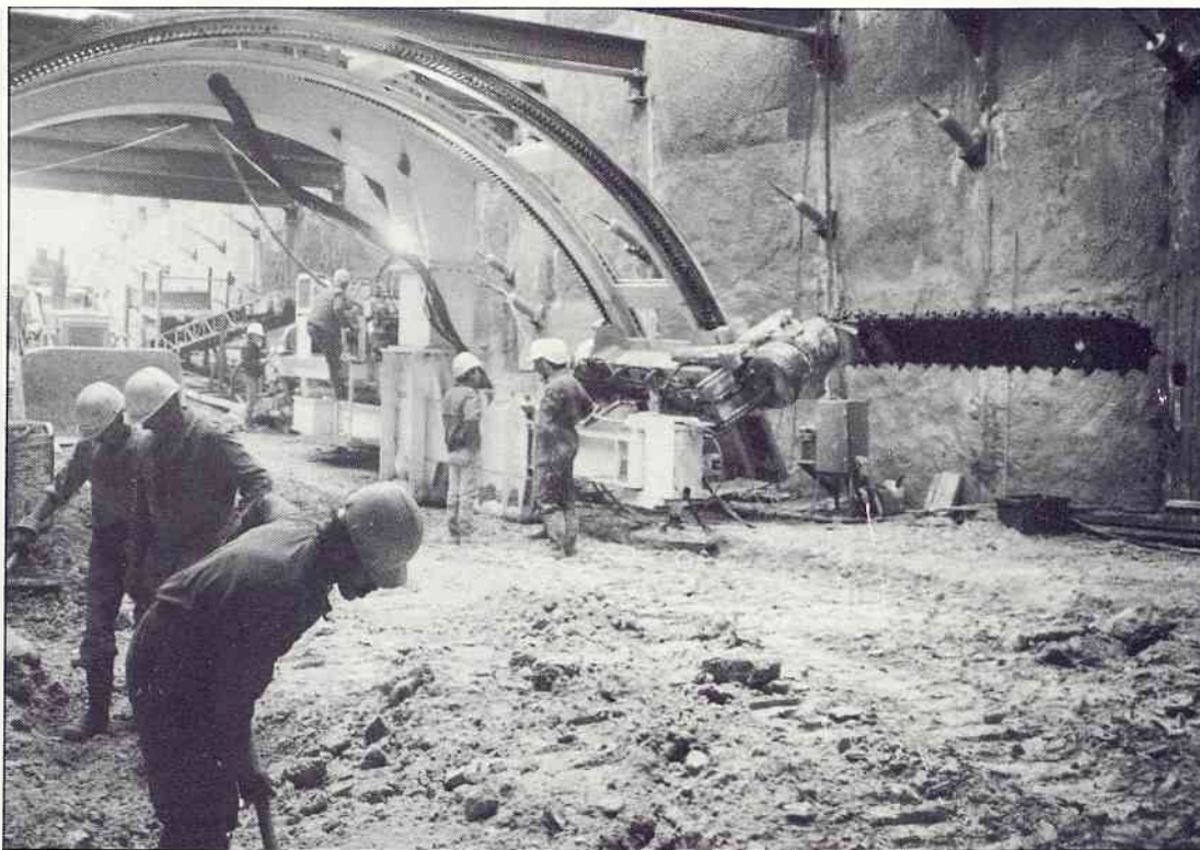
Machine de l'entreprise Perforex. On aperçoit, à droite, le bras tenant la chaîne-scie pouvant entailler le terrain. Le bras tourne lentement en suivant la courbe de l'arc à crémaillère épousant la forme circulaire de la voûte.
