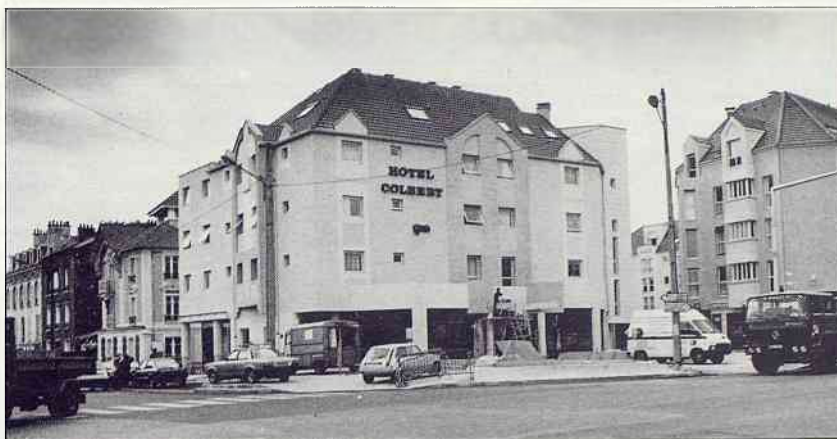
A quelques heures de l'ouverture de l'hôtel, à l'intérieur comme à l'extérieur, un chantier encore très actif.
