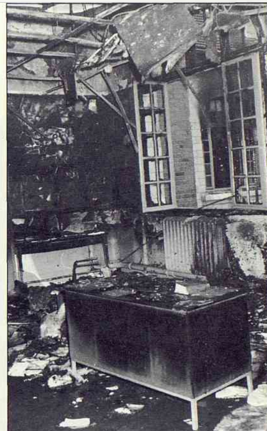
Dans ce bâtiment, les mesures de sécurité n'avaient pas été respectées.
