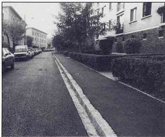
Rue du Docteur-Lequeux : réfection des trottoirs et de la chaussée ; mise en souterrain du réseau PTT.
