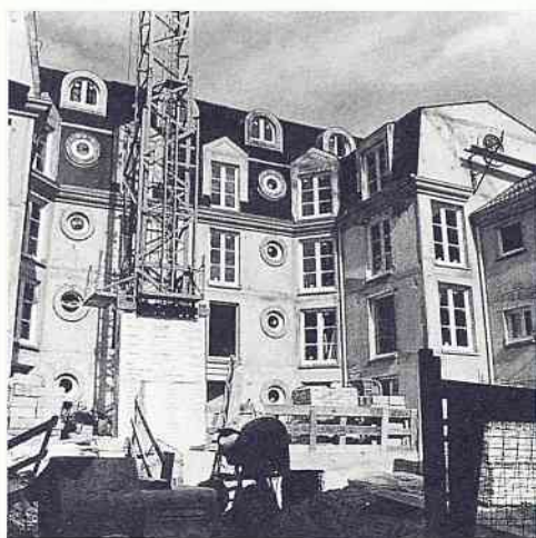
Rue des Écoles, 22 logements PLI
