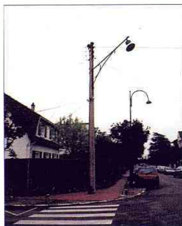
Vue de l'éclairage ainsi que du réseau EDF existant et du nouveau support et lanternes d'éclairage.
