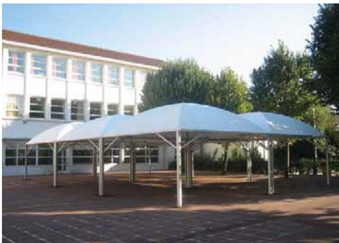
Un nouveau préau à la structure légère installé à l'école du Petit-Chambord abrite désormais les enfants dans la cour.
